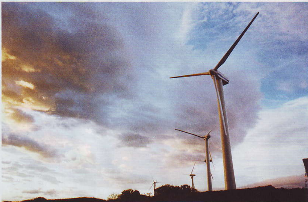
La planta eléctrica Tejona fue el primer parque eólico instalado en Costa Rica. Tiene una capacidad de 20 MW, suficiente para surtir de energía a más de 13.000 viviendas.
